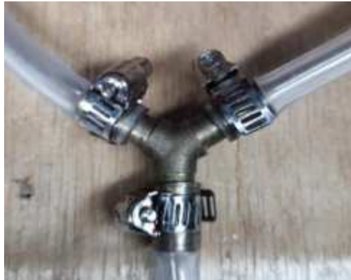
Gambar 40. Sambungan selang gas cabang 3
