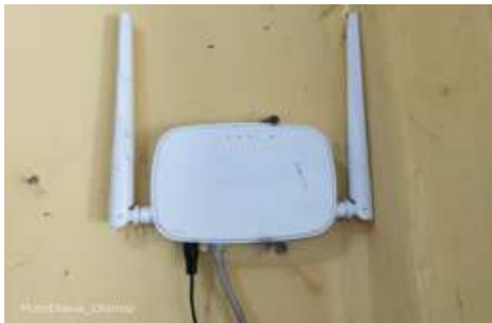
Gambar 39. Access Point pada Kantor Balai Desa Sambikarto (sumber: penulis, 2023)
