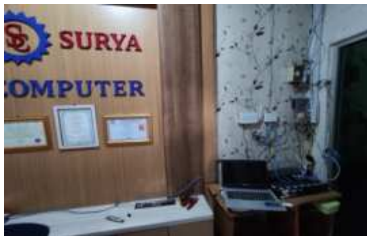
Gambar 9 Ruang server jaringan LKP Surya Komputer. (Sumber: penulis 2024).
