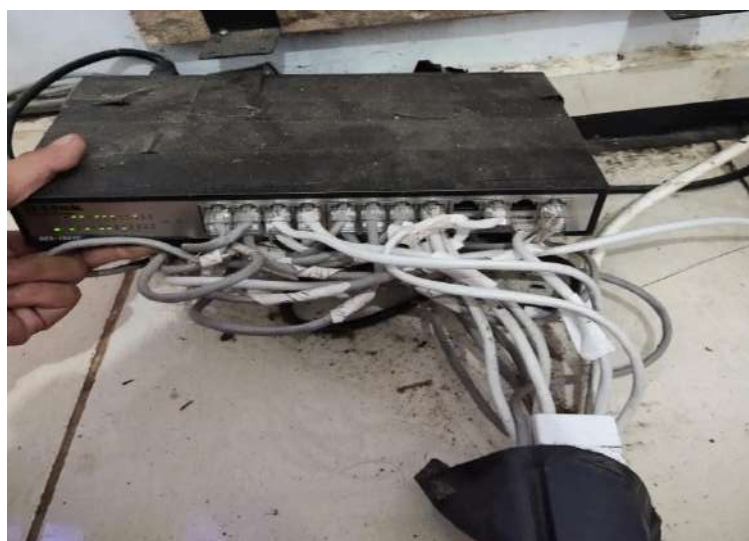
Gambar 32. Switch 24 port (Sumber: penulis,2022).
