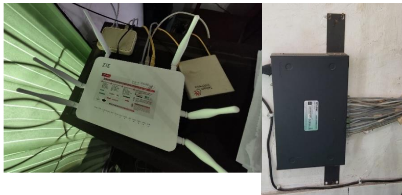
Gambar 23. Ruang Server Jaringan Pada SMP Tarbiyyatul Mu'alimin Al-Islamiyyah Roudhlatul Qur'an Metro (Sumber: Penulis, 2022)
