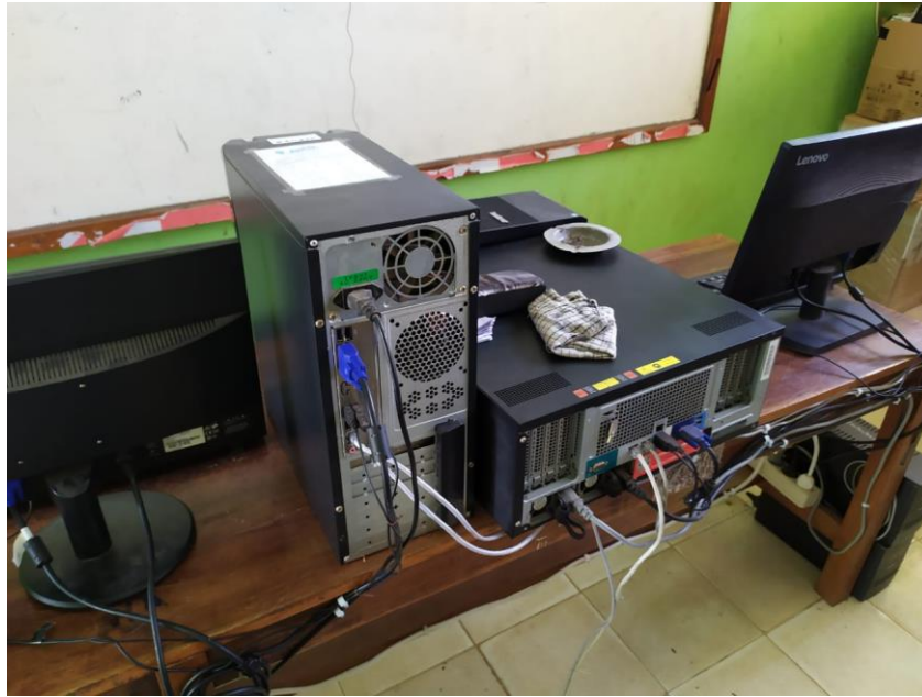
Gambar 21. Komputer Server pada ruang lab. (Sumber. Penulis 2022).
