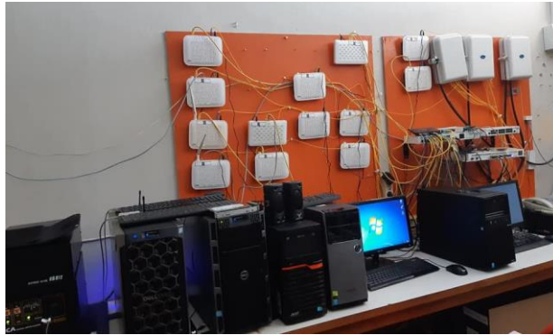
Gambar 40. Ruang Server SMP Negeri 7 Metro (Sumber: Penulis, 2021)
